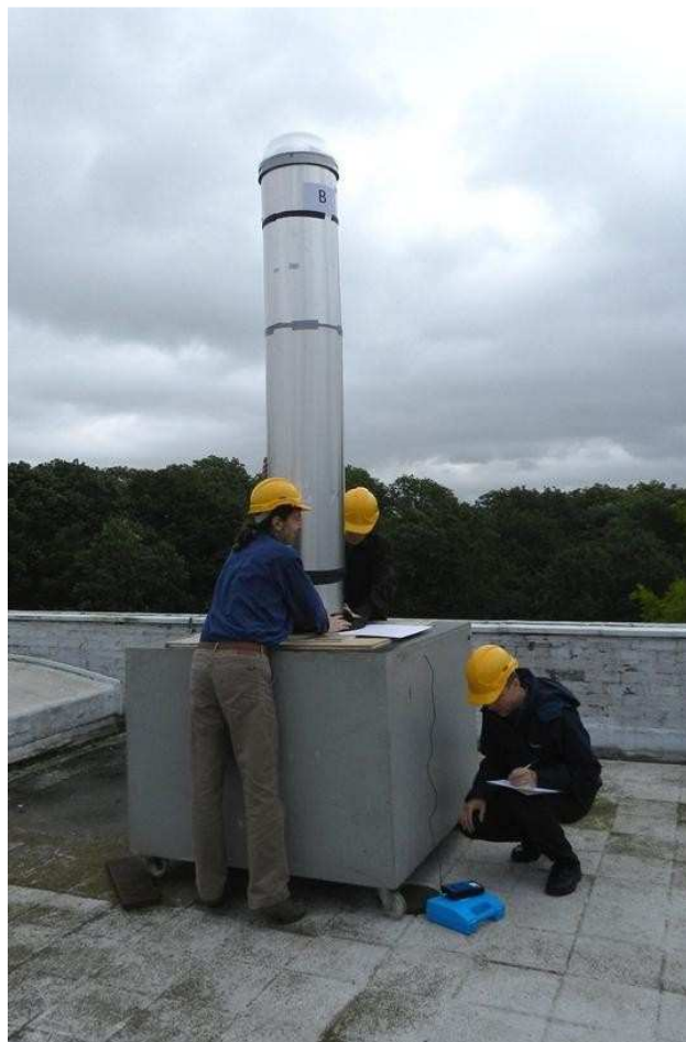
4. ábra Fénycsatornával (Solar spot D-38, szimpla üveges felső kupola, Convax lencse nélkül) végzett vizsgálat a tetőn
